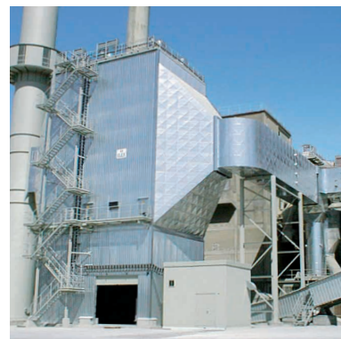
ЦЕМЕНТНЫЙ ЗАВОД, Германия ПЕЧЬ С ТЕПЛОБМЕННИКОМ - МЕЛЬНИЦЫ
